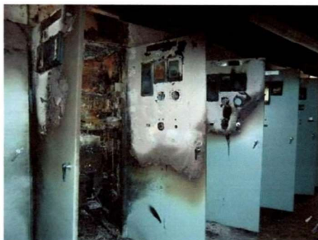
高圧電源盤 現場写真
