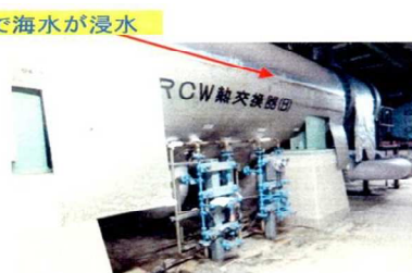
原子炉補機冷却水口系熱交換器室
