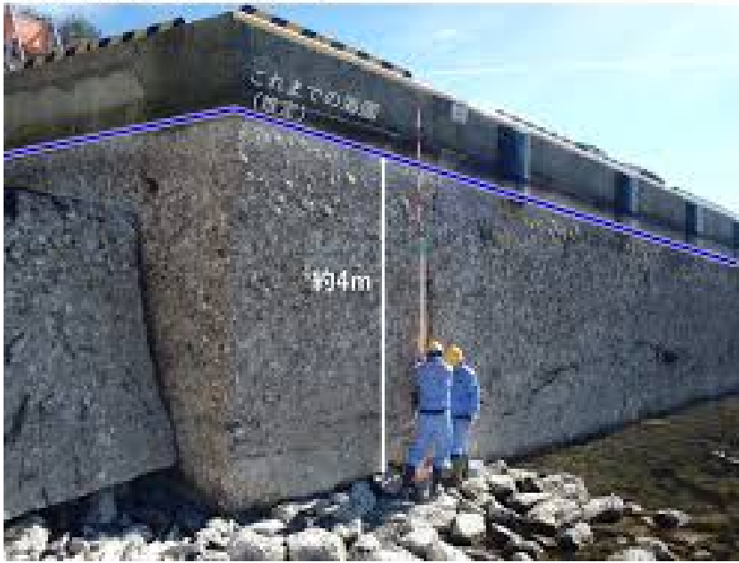
直磯漁港で約4mの隆起を確認
